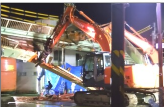
歩道部分の鉄板が落ちました。これでやっと半分
