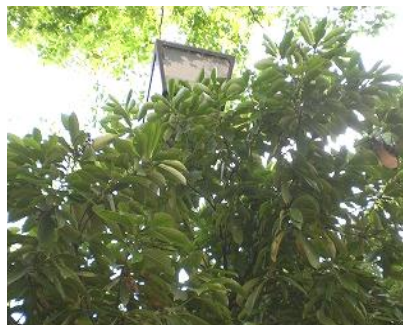
植栽が繁茂しすぎて照明を隠している古久喜公園
