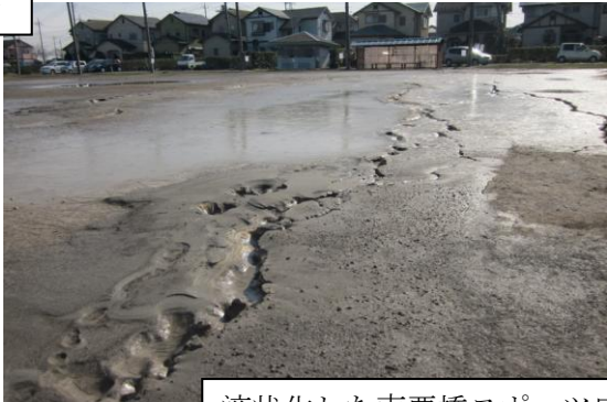
液状化した南栗橋スポーツ広場
