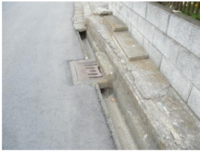
本町2丁目の側溝。見たとおり、古くて浅いのでゲリラ豪雨時にはすぐあふれる。抜本的対策強化を。
