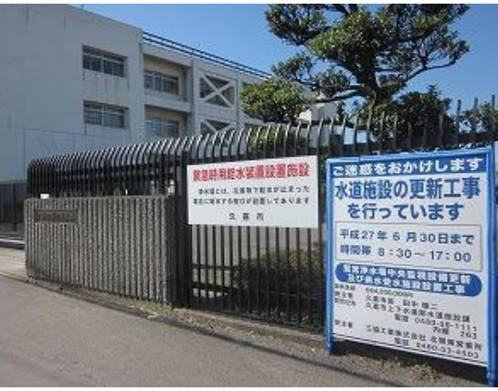
鷺宮浄水場中央監視設備更新 県水受水施設設置工事 5億5710万4,000円 監視制御設備 約2億円を廃棄
