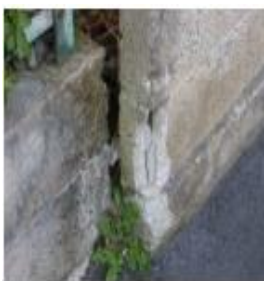
ブロック塀の破損
