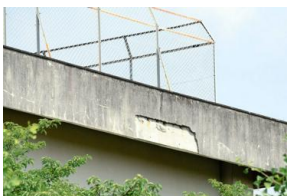
外壁落ちた久喜東中！
